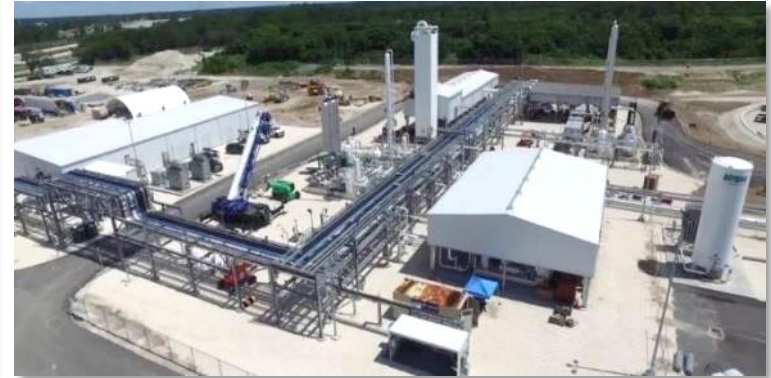
Modular LNG Plant
